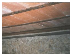
Solai mal collegati alle murature
